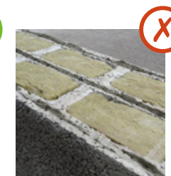
Quantité insuffisante de colle
